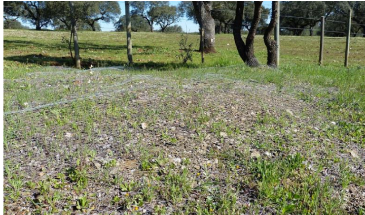
Fig. 26 – Colocação de rede sobre os taludes da EN4, aproximadamente entre os km 88,315-88,815 e 130,660-131,160, com o objetivo de impedir a sua colonização por coelhos.
